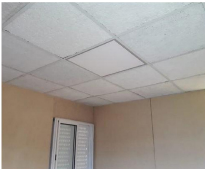
Figura 4. Placas colocadas en la oficina del puerto de la ciudad de Santa Fe.
